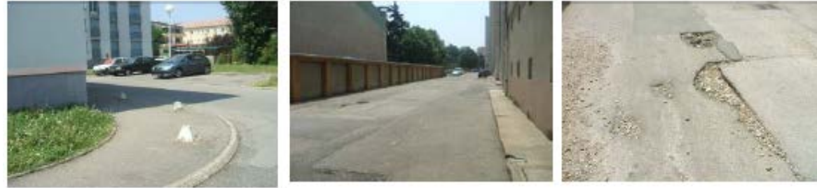
Différents désordres et aménagements sur chaussées privées
