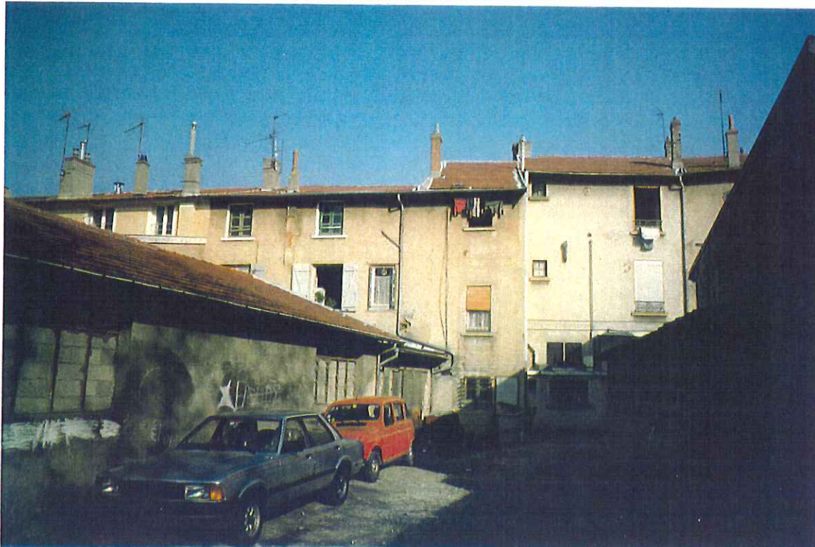
2.18 Les façades sur cour des immeubles et les constructions annexes en cœur d'îlot.
