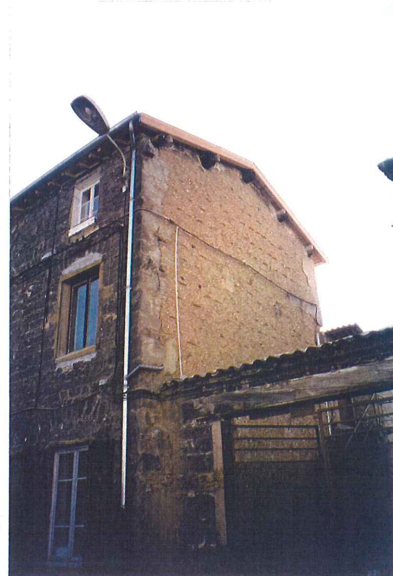
1.13 Façades en pierres sur rue et pisé pour les autres murs; certains immeubles mériteraient un entretien plus complet.
