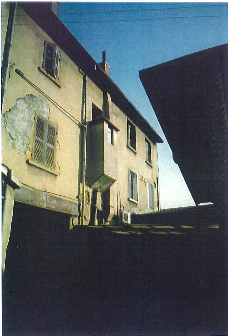
2.19 Les façades sur cour sont plus dégradées et laissent apparaître les murs en pisé.
