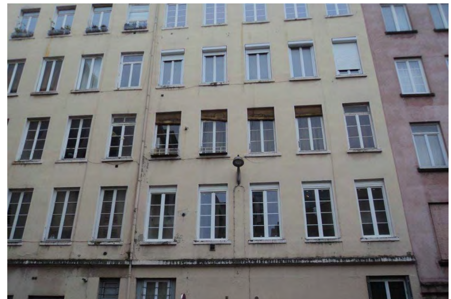
Equipements de production de chaleur et conséquences visuelles en façade. Photographies : ThermiFluides.
