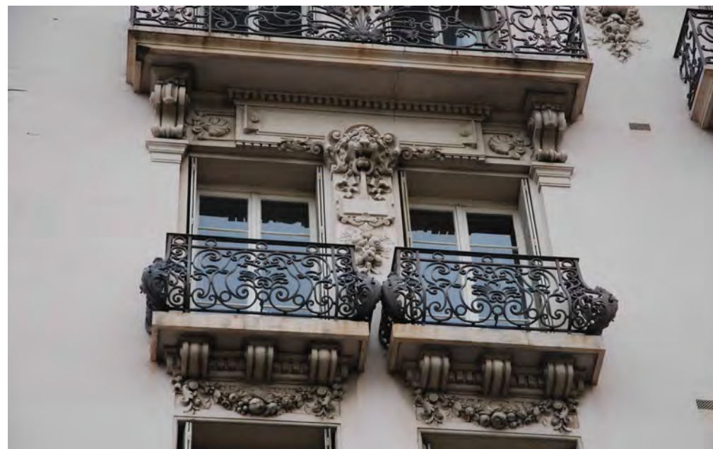
Tout n'est pas pierre et bois : la terre cuite ou crue est très présente, de même que les ciments, notamment sous formes de moulages décoratifs.
