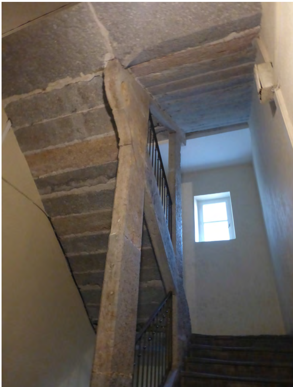
L'escalier du 28, rue Burdeau, beau représentant des murs porteurs ajourés, précédant les escaliers dits «à l'anglaise» développés massivement après 1840-1850.
