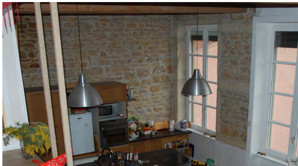
Poutres et murs en pierre apparente sont omniprésents dans ces immeubles. Toutefois, l'absence d'enduit favorise les infiltrations d'air froid et augmente la consommation énergétique.
