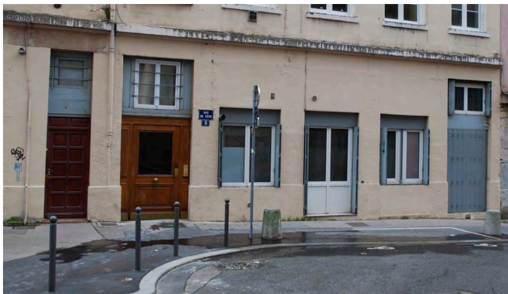
Diverses vues du rez-de-chaussée ou autres parties de l'immeuble. Les menuiseries ne sont pour la plupart plus conformes.
