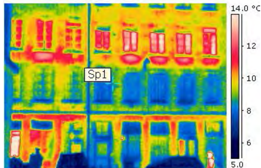
Thermographie de la façade. (rouge = chaud, ce n'est pas bon.) Photographies : ThermiFluides.
