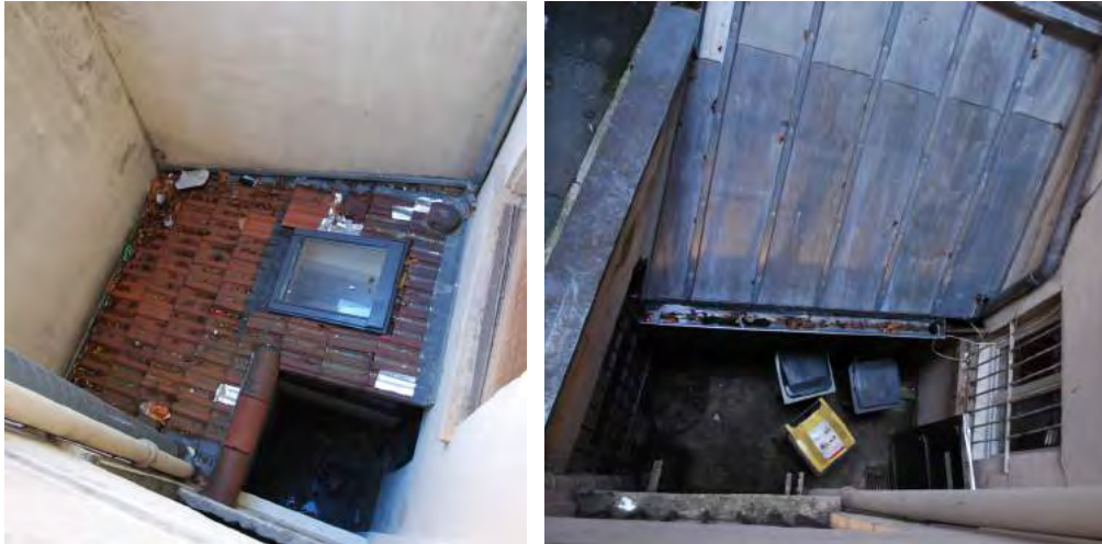
Quelques exemples d'édifices de «catégorie 3 : C3» dont l'emplacement sera laissé libre de toute construction s'ils venaient à être démolis.
