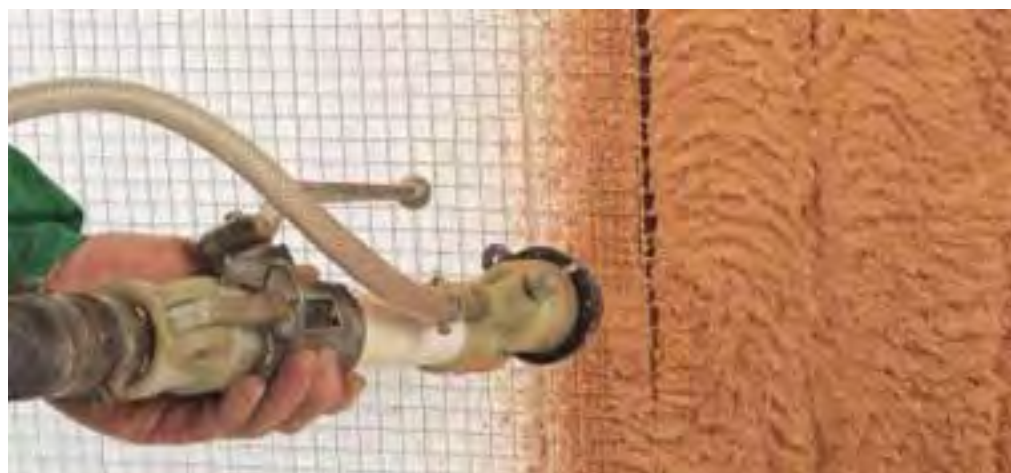
Les pertes de chaleur en façade (en rouge.) et deux solutions potentielles : l'isolation par l'extérieur traditionnelle (matériaux surajoutés) ou effectuée à l'aide d'enduits isolants.
