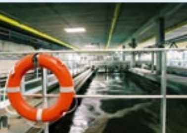
Bassin de traitement biologique
