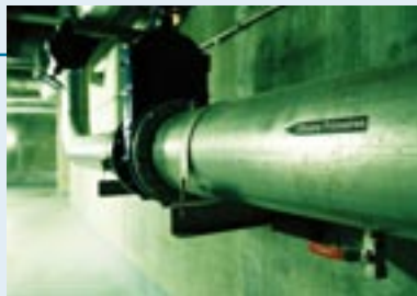
Boues issues des décanteurs lamellaires acheminées vers les épaisseurs
