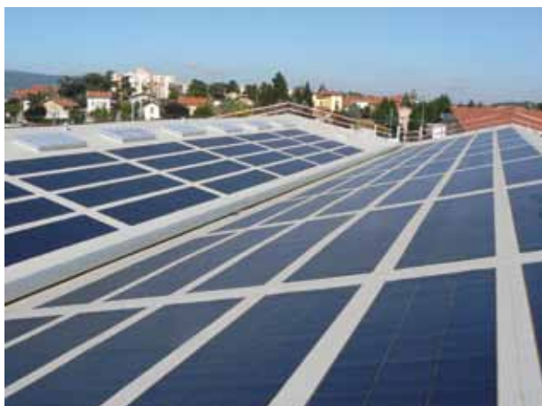
Membrane photovoltaïque sur l'entreprise Touly à Rillieux-la-Pape Source ALE Lyon
