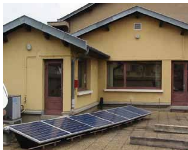
Installation photovoltaïque du lycée la Martinière Terreaux Source ALE Lyon.
