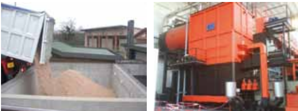
Livraison de bois déchiqueté à la chaufferie de la Tour de Salvagny et chaudière bois à la Duchère - Source ALE Lyon
