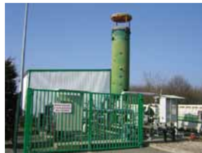
Méthanisation au CET de Rillieux-la-Pape.
