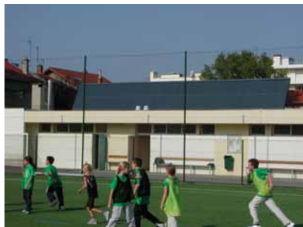
Eau chaude solaire au stade Marc Vivien Foe, Lyon 3 e Source ALE Lyon
