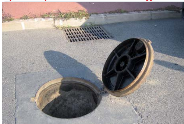
Puits d'infiltration avec tampon ouvert
