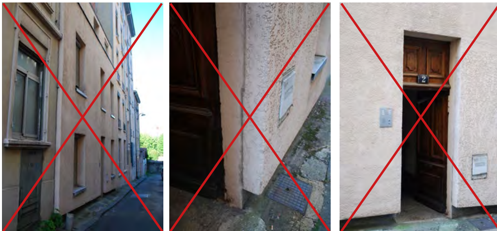
Les sur-épaisseurs de plus de trois centimètres en façade sont proscrites. De fait, les isolations thermiques extérieures traditionnelles sont impossibles.
