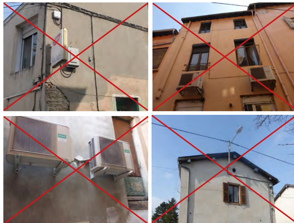
Les mobiliers hauts, éclairages publics, équipements techniques et réseaux (électriques notamment) ne doivent pas altérer les façades et doivent être intégrés au sein du bâti lorsque cela est possible.
