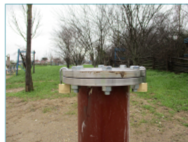
Source SUEZ Photographie de la tête du piézomètre installée sur le futur puits de captage des eaux souterraines - Janvier 2021
