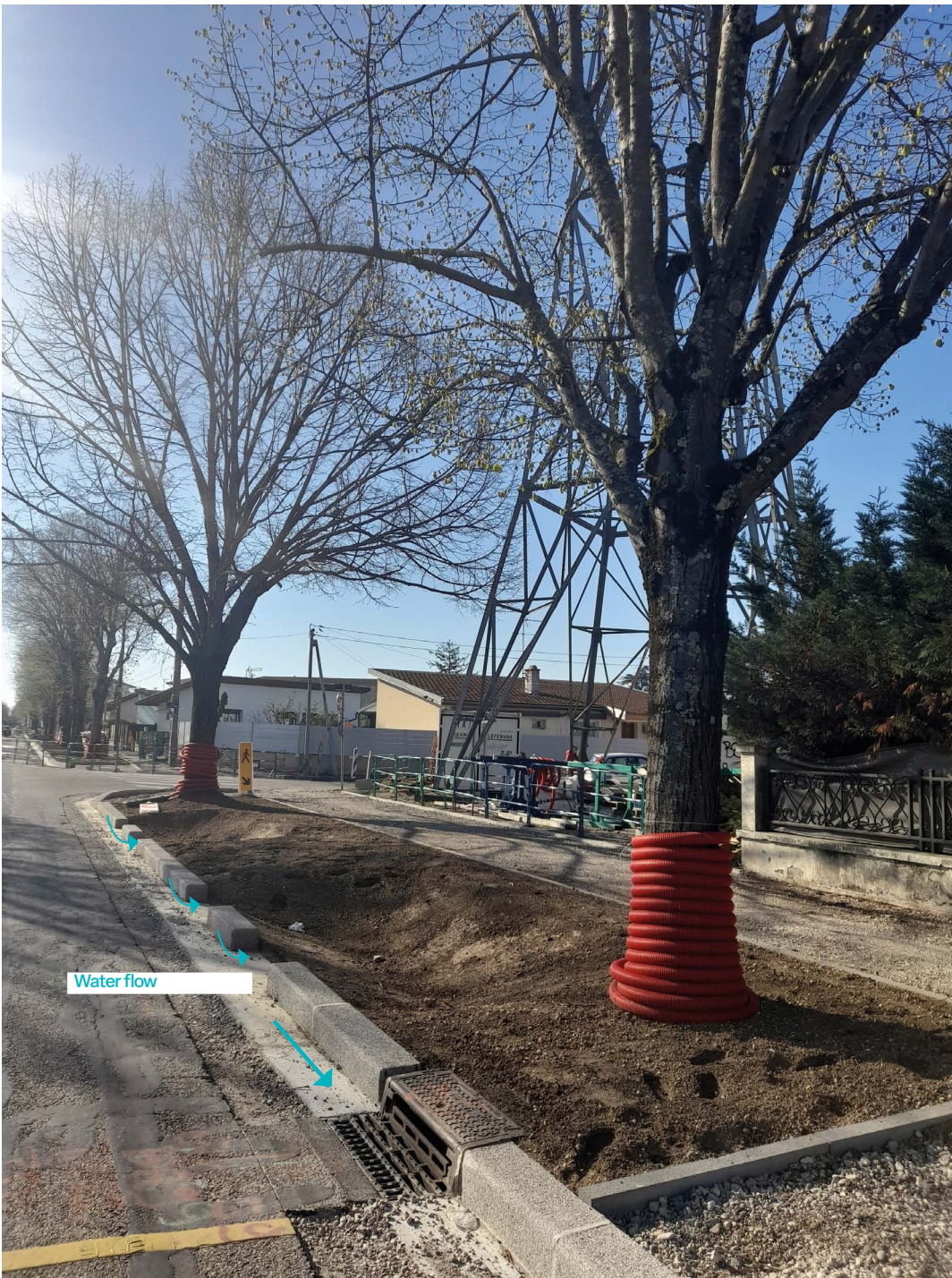
> Pre-existing grid at the low point of the development on Boulevard du Docteur Coblod, Vénissieux
